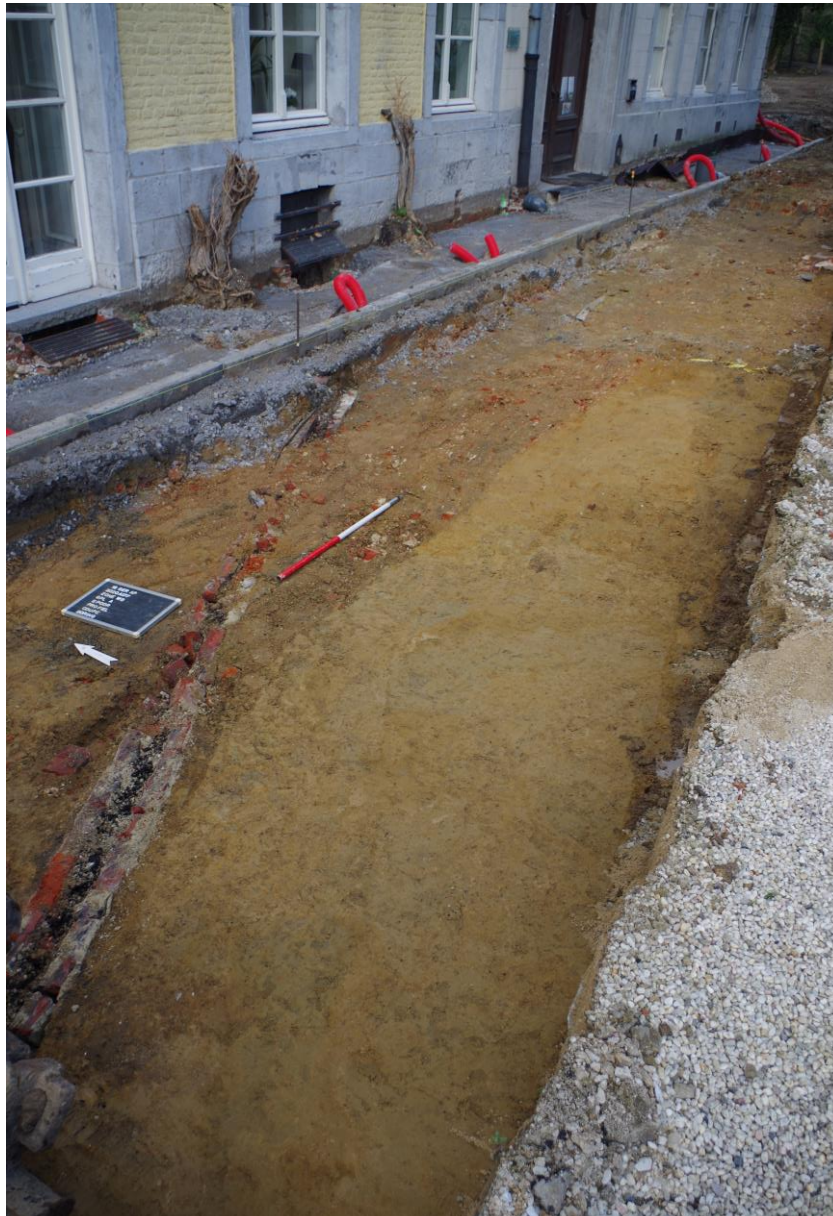
Foto 14 Opbraak van de bestaande toestand ter hoogte van de zuidoostelijke gevel van het Abtenhuis (grondplan A, Fig. 11), gezien vanuit het zuidwesten. Rechts bovenaan op de foto ligt de zone van de muren
