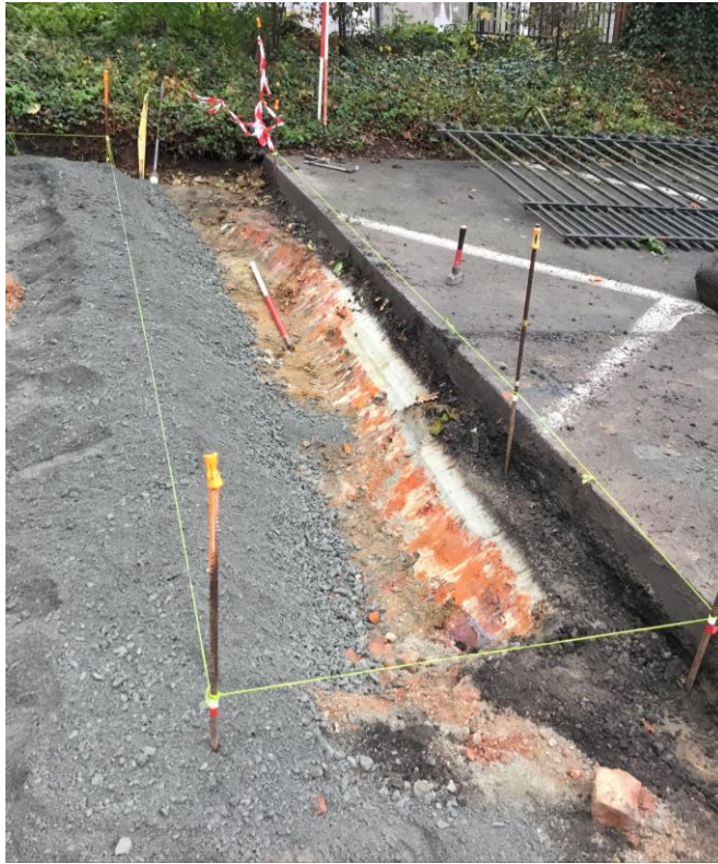
Foto 47 Opbraak en heraanleg van de parking met verdiept gedeelte langs de rand, zicht vanuit het noordwesten
