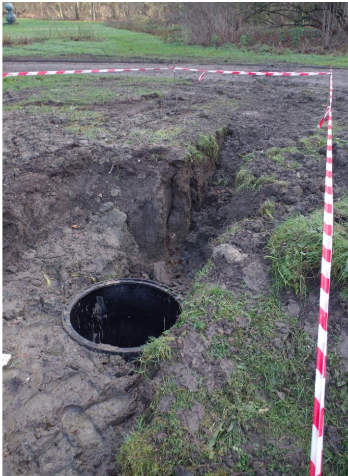
Foto 86 Pompput ter hoogte van de vijver, gezien vanuit het westen
