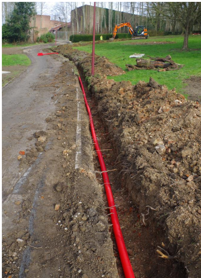
Foto 88 Sleuf voor de nutsleidingen richting het Chinees paviljoen, gezien vanuit het zuidwesten. Puinlaag WB-31 is duidelijk zichtbaar. Rechts bevindt zich de speelgoot
