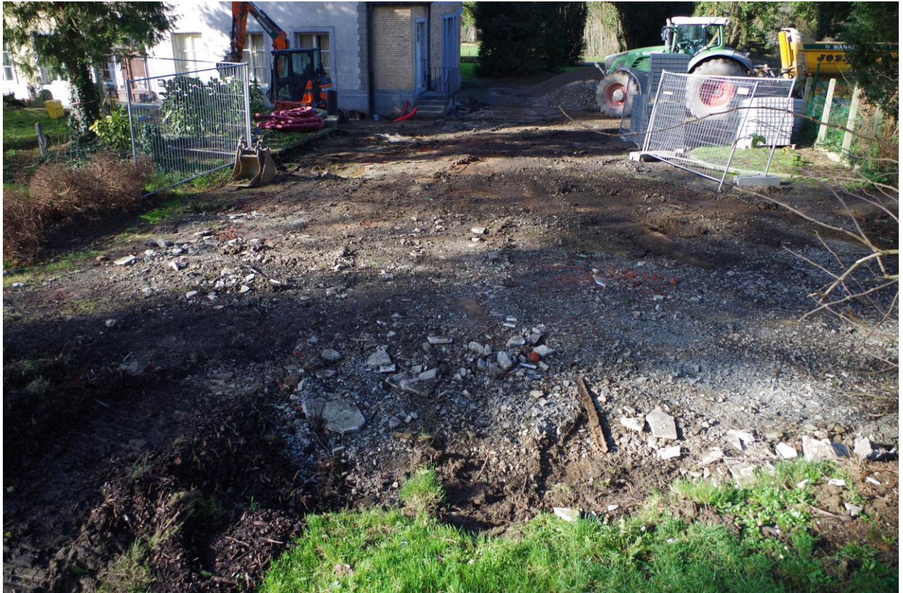
Foto 41 Opbraak van de bestaande wandelpaden in het noordelijke deel, gezien vanuit zuidoosten. Op de achtergrond is het Abtenhuis zichtbaar
