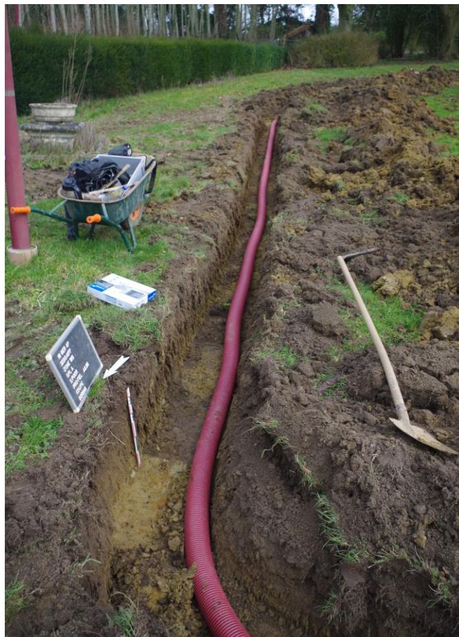
Foto 90 Sleuf voor de nutsleidingen richting het Chinees paviljoen, gezien vanuit het westen. De natuurlijke bodem is plaatselijk aangesneden
