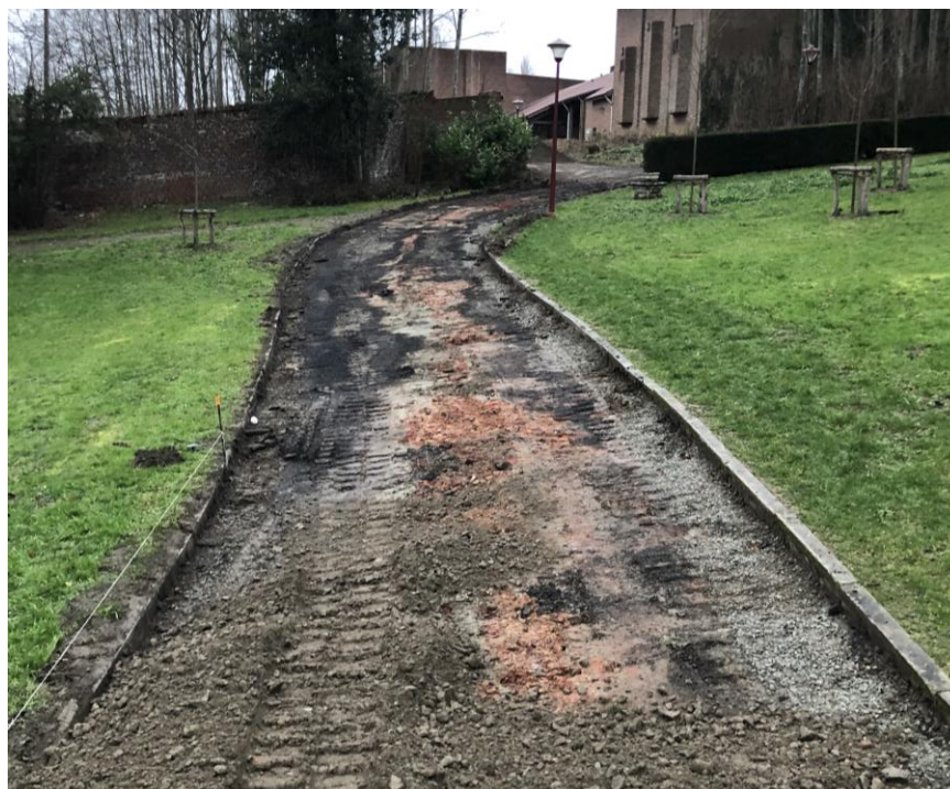
Foto 102 Heraanleg van het wandelpad ten oosten van de vijver, zicht vanuit het zuidwesten
