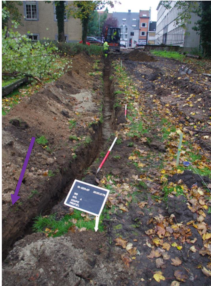
Foto 65 Uitgraving voor de nutsleidingen naast de dienstweg, de paarse pijl duidt profiel A4C4 aan, zicht vanuit het noorden. Links is de achterzijde van het poortgebouw te zien
