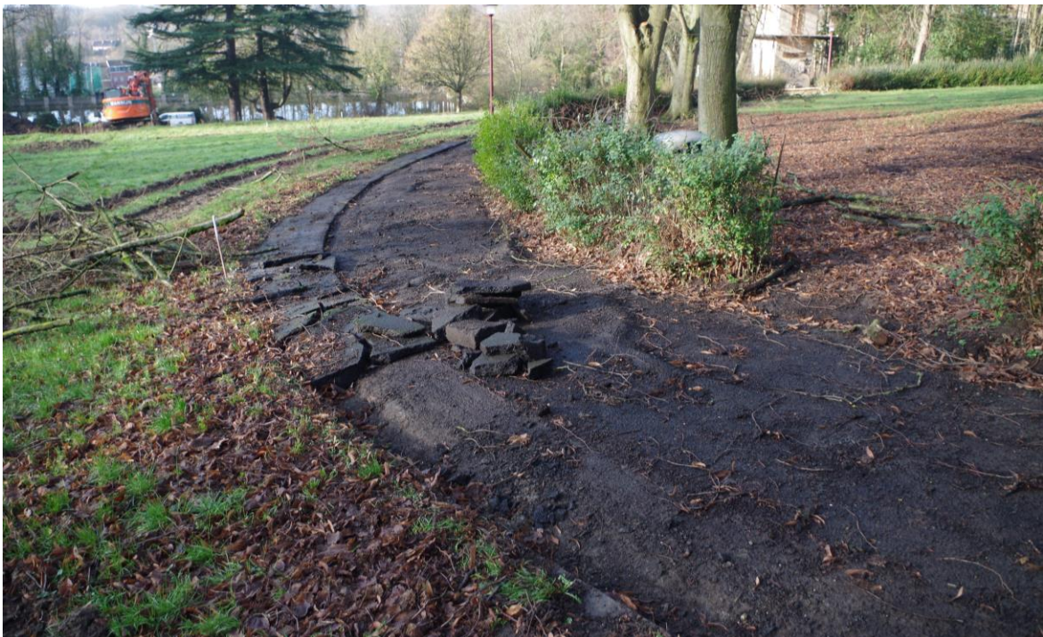
Foto 71 Opbraak van de bestaande wandelpaden net ten zuiden van de speelzone, gezien vanaf het zuidoosten
