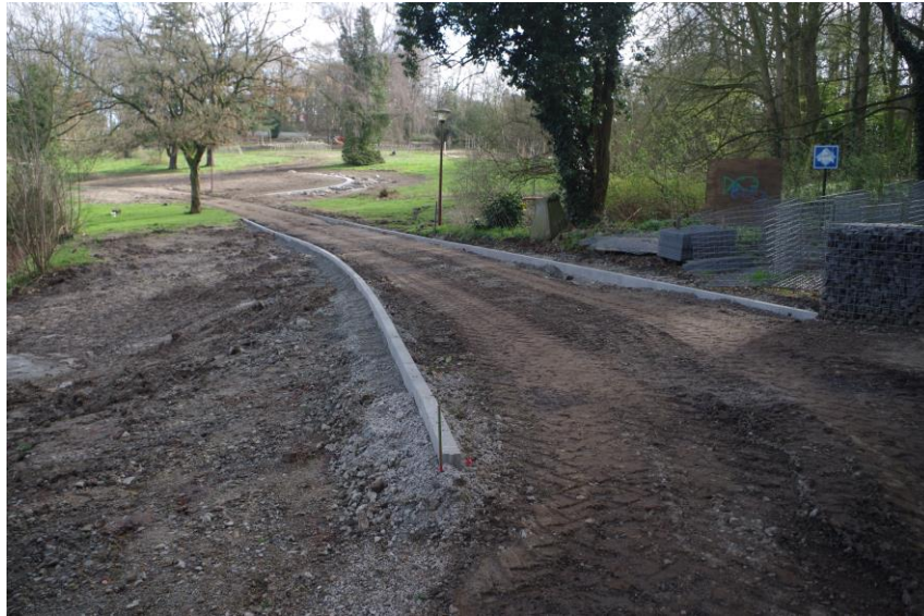
Foto 104 Uitbraak en vervanging van de boordstenen ten zuiden van de grote vijver, gezien vanuit het zuidwesten
