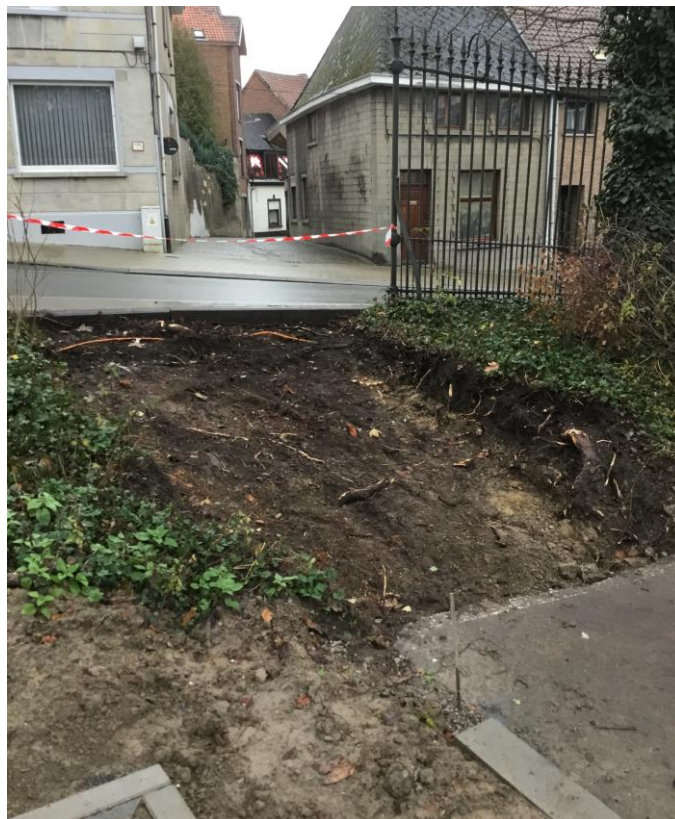
Foto 50 Uitgraving in functie van de toegang net ten zuiden van de parking. Op de achtergrond is de Bokerstraat te zien
