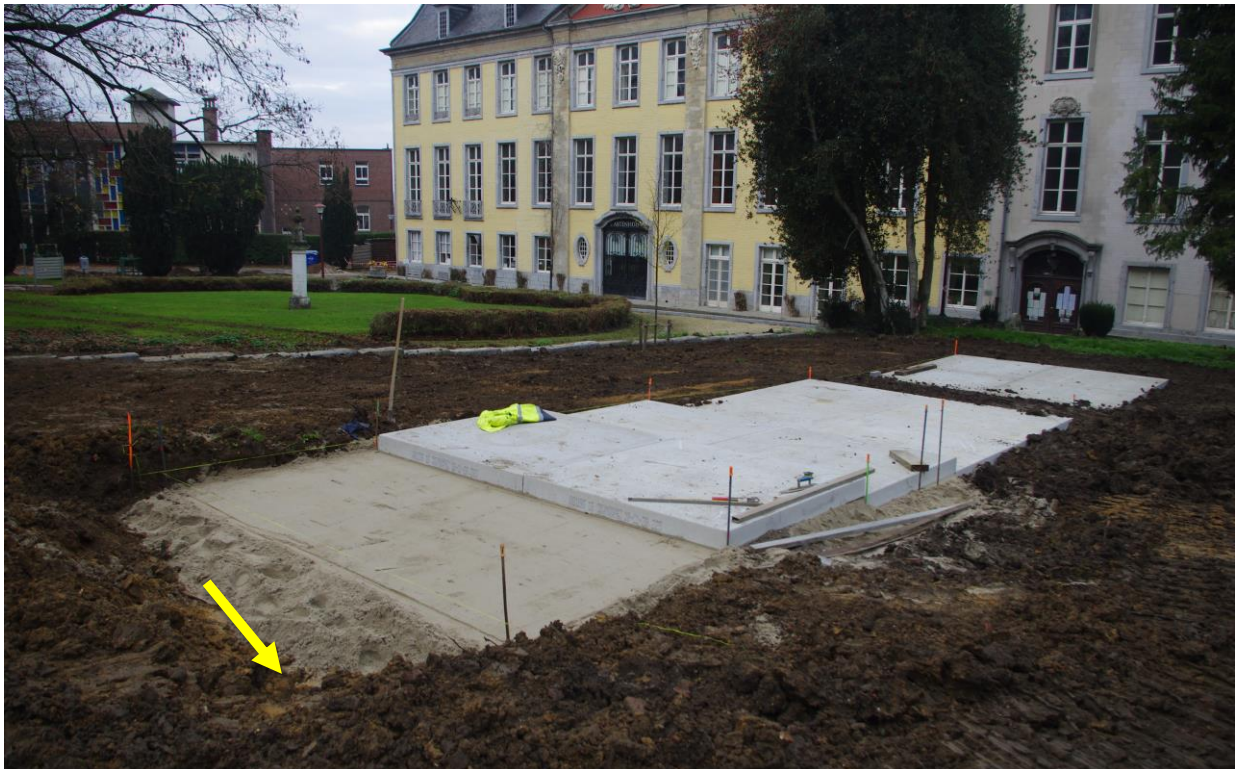
Foto 36 Aanleg van de zit- en speelplateaus ter hoogte van de voormalige conventsgebouwen, op de achtergrond is het Abtenhuis te zien. De gele pijl duidt de locatie van profiel A13C13 aan, zicht vanuit het zuidoosten
