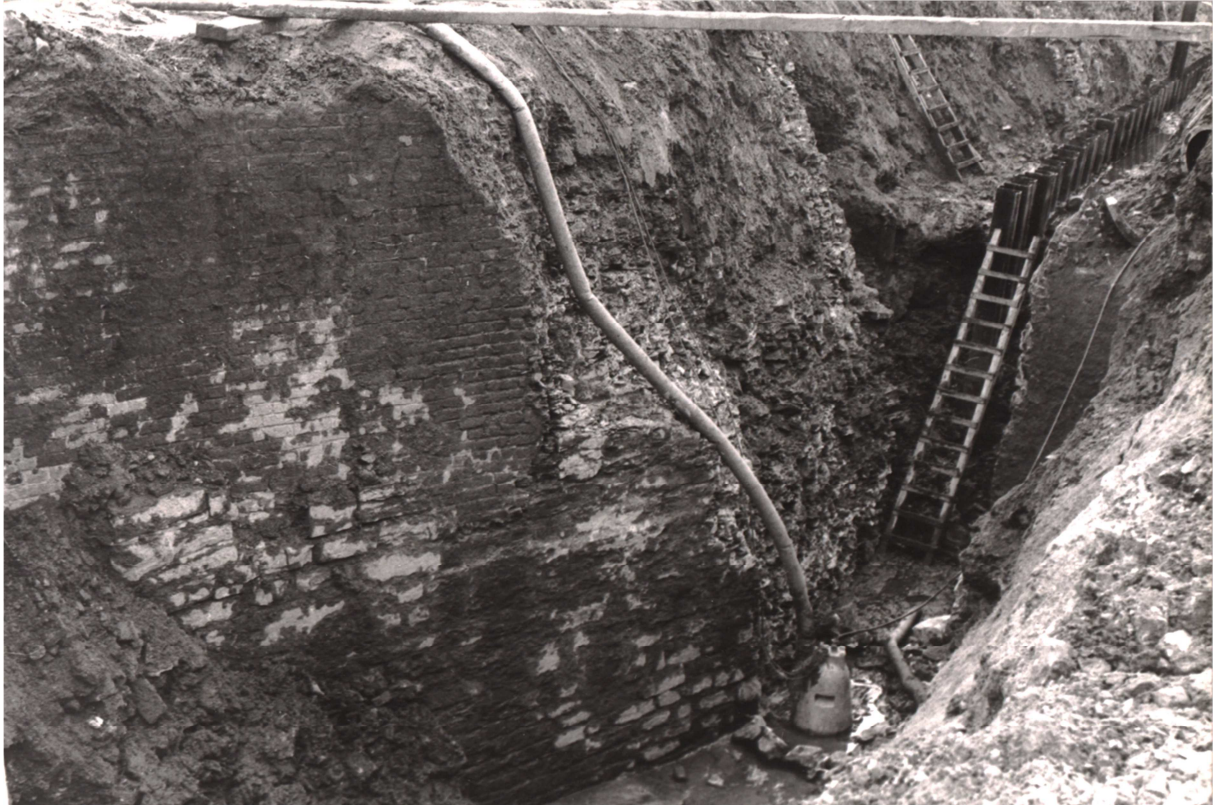
Figuur 30: Zicht op de damplaten voor de rechtbrekking van de Schelde. Uitbraak van massieve funderingen die wellicht toebehoren aan de Steenpoort en Steenbrug. (Bron: SAO - FO 001165-8)
