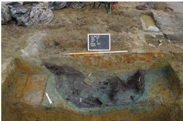
Afb. 127: Zicht op uitgebroken beschoeiing van S. II-825.
