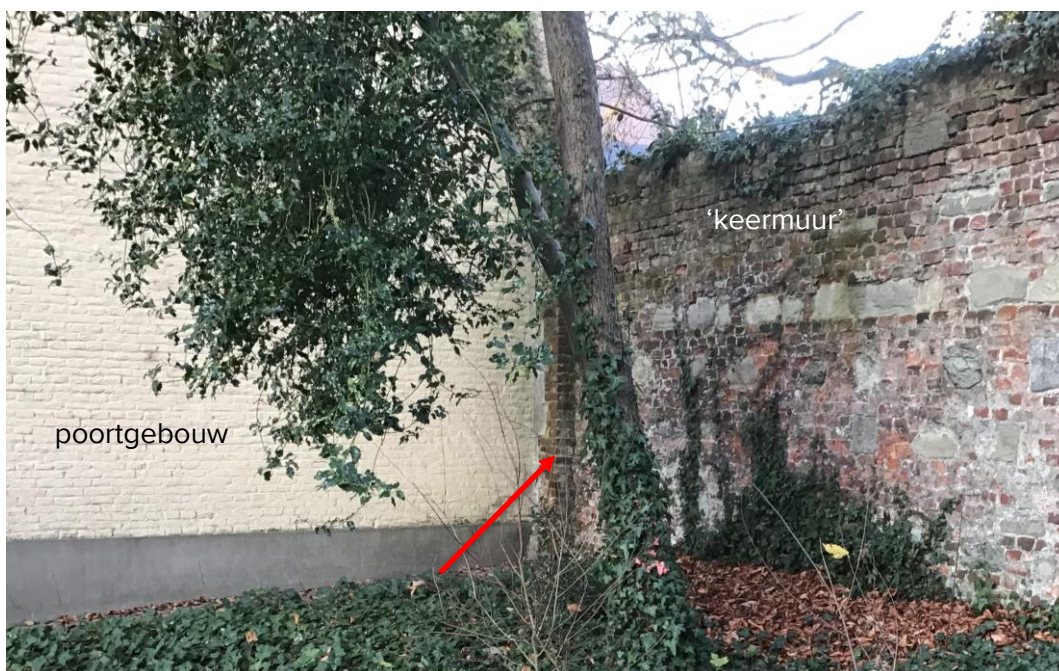
Figuur 19: zicht op de bouwvolumes van het poortgebouw (links) en de 'keermuur' (rechts) langs de huidige parking, in de hoek zijn enkele natuurstenen zichtbaar die mogelijk de hoek vormen van de 18 de -eeuwse kerkgevel, de rode pijl geeft de uitspringende hoek aan
