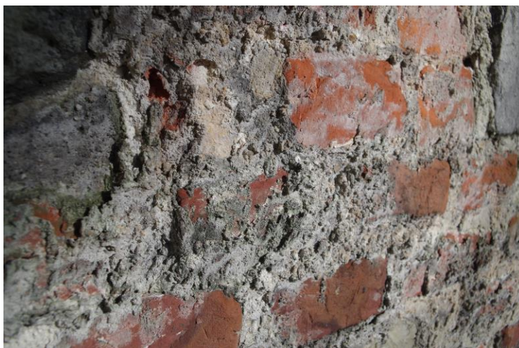
Figuur 36: restanten pleisterlaag op het metselwerk
