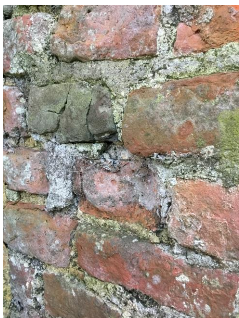
Figuur 35: restanten pleisterlaag op het metselwerk
